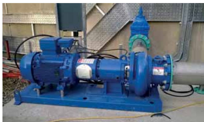
Chaque pompe broyeuse est entraînée par un moteur Weg EEx-d de 30 kW, de classe IE2, conforme aux spécifications WIMES, les standards mécaniques et électriques applicables au secteur de l'eau au Royaume-Uni.
