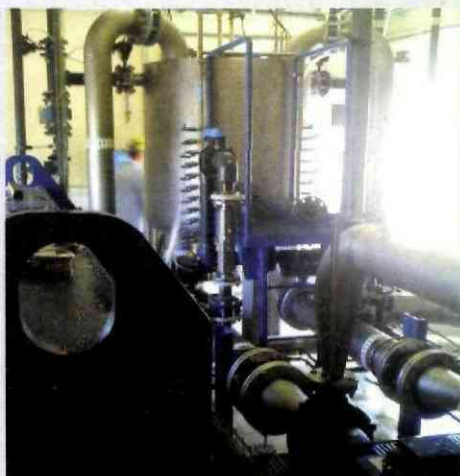
Le pilote FBC est actuellement en test dans une usine de traitement des effluents industriels.
